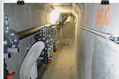
4. Galerie souterraine. Située sous les ouvrages de stockage, elle récupère les eaux d'infiltration qui traversent les ouvrages.
