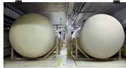
5. Cuvées (contenant 10 m 3 chacune) dans lesquelles sont entreposés les effluents à risque.
