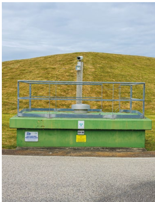
Chambre de drainage de surface
