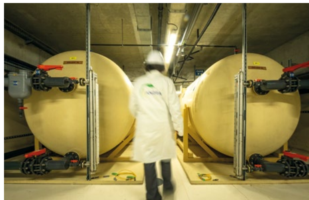
Cuves de collecte du réseau séparatif gravitaire enterré
